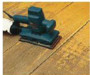
Voor herstelling dient de vloer totaal afgeschuurd te worden
